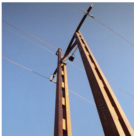
Photo du pylône électrique Grand Duc
