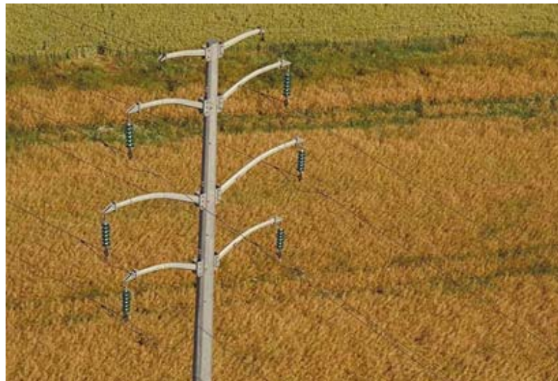
Photo du pylône électrique Muguet.
