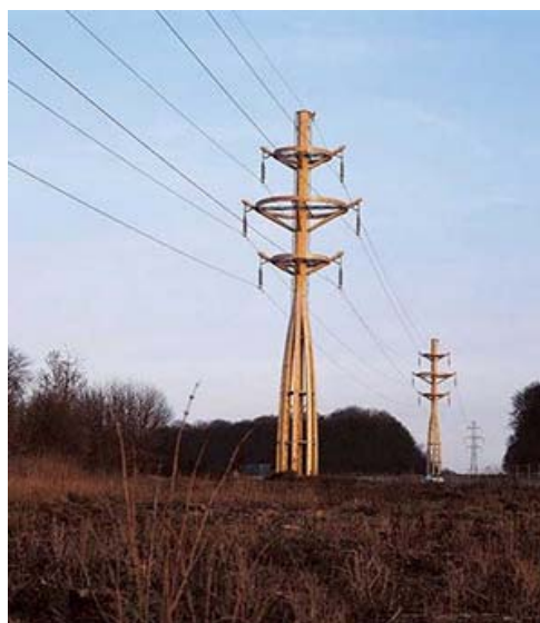
Photo du pylône électrique Corolle
