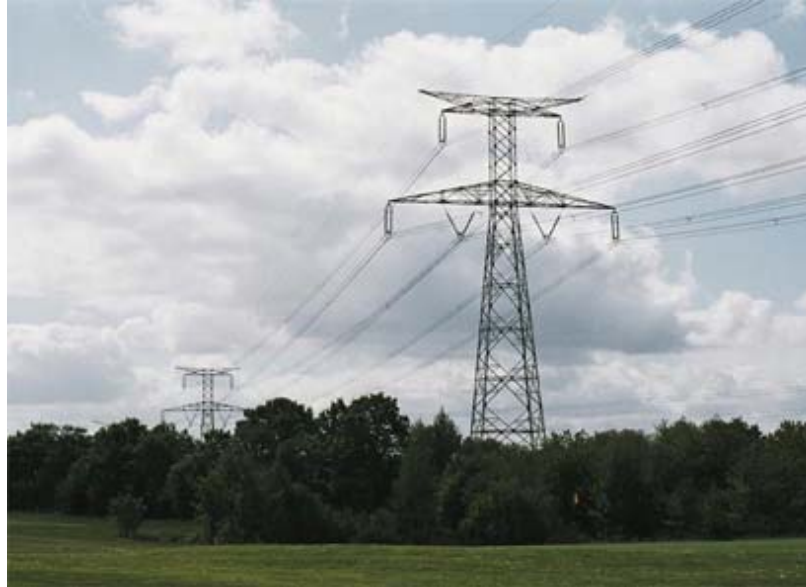
Photo d'un pylône électrique Beaubourg.
