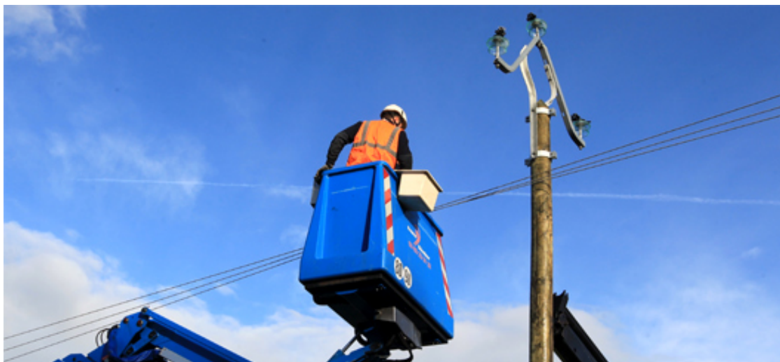
Enedis est entre autres en charge de l'entretien du réseau de distribution de l'électricité.
